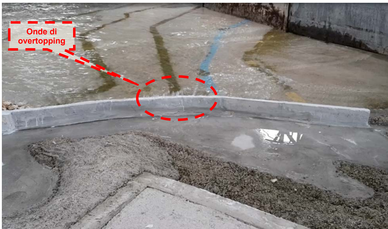
Fig. 7.3.1: scavalco, da parte delle onde più alte, della parte centrale della prosecuzione del muro paraonde del molo di sottoflutto (attacco ondosu TR 50 anni).
