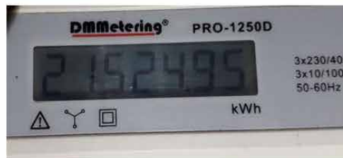
FIGURA 1 – CONTABILIZZATORE ENERGIA ELETTRICA - CANTIERE DIMEG
