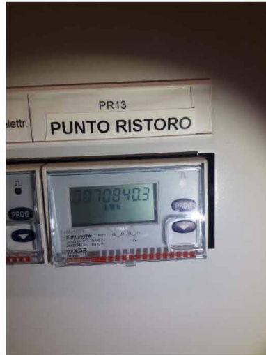
FIGURA 2 - CONTABILIZZATORE ENERGIA ELETTRICA - PUNTO RISTORO
